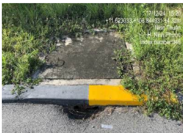
Hình 3.2: Hố ga thu nước mưa
