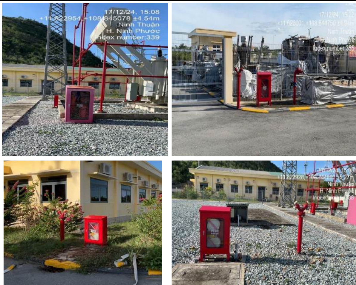
Hình 3.29: Công trình phòng chống, ứng phó sự cố cháy nổ
