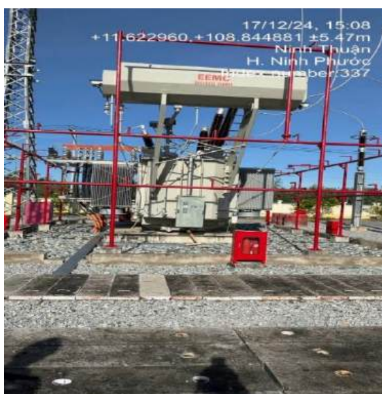
Hình 3.15: Bể thu dầu sự cố trạm biến áp
